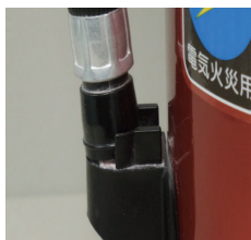
× 消火薬剤の漏れ
